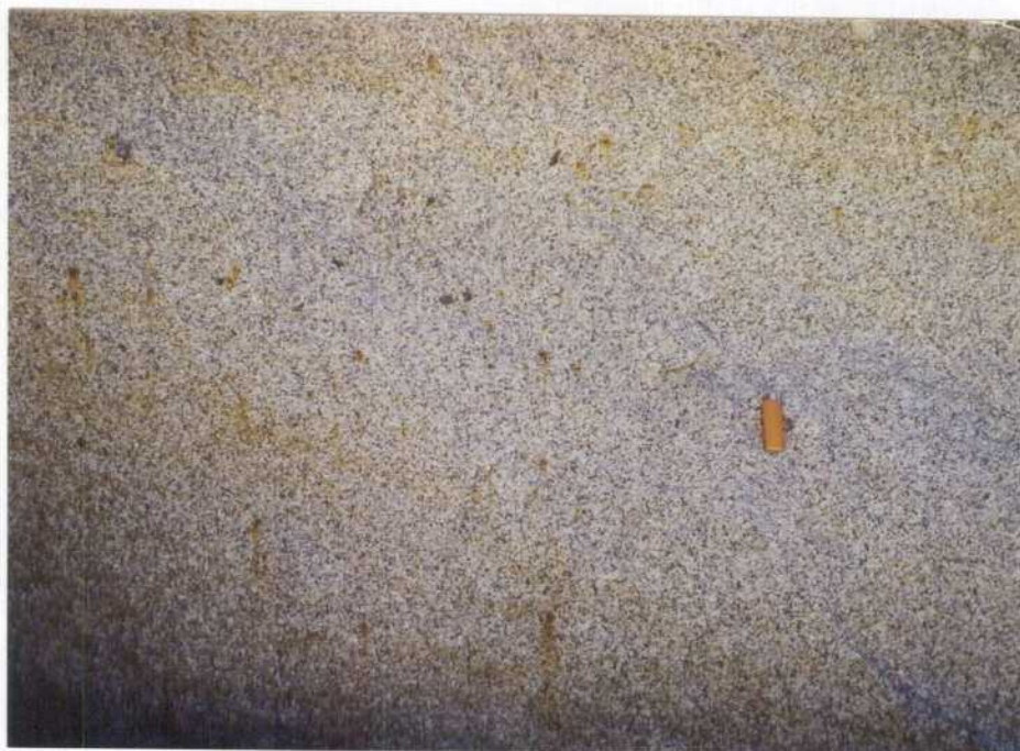
Foto 22 (31).- Hoja 216. Detalle del granito de la fotografía anterior. Observense las oxidaciones.
