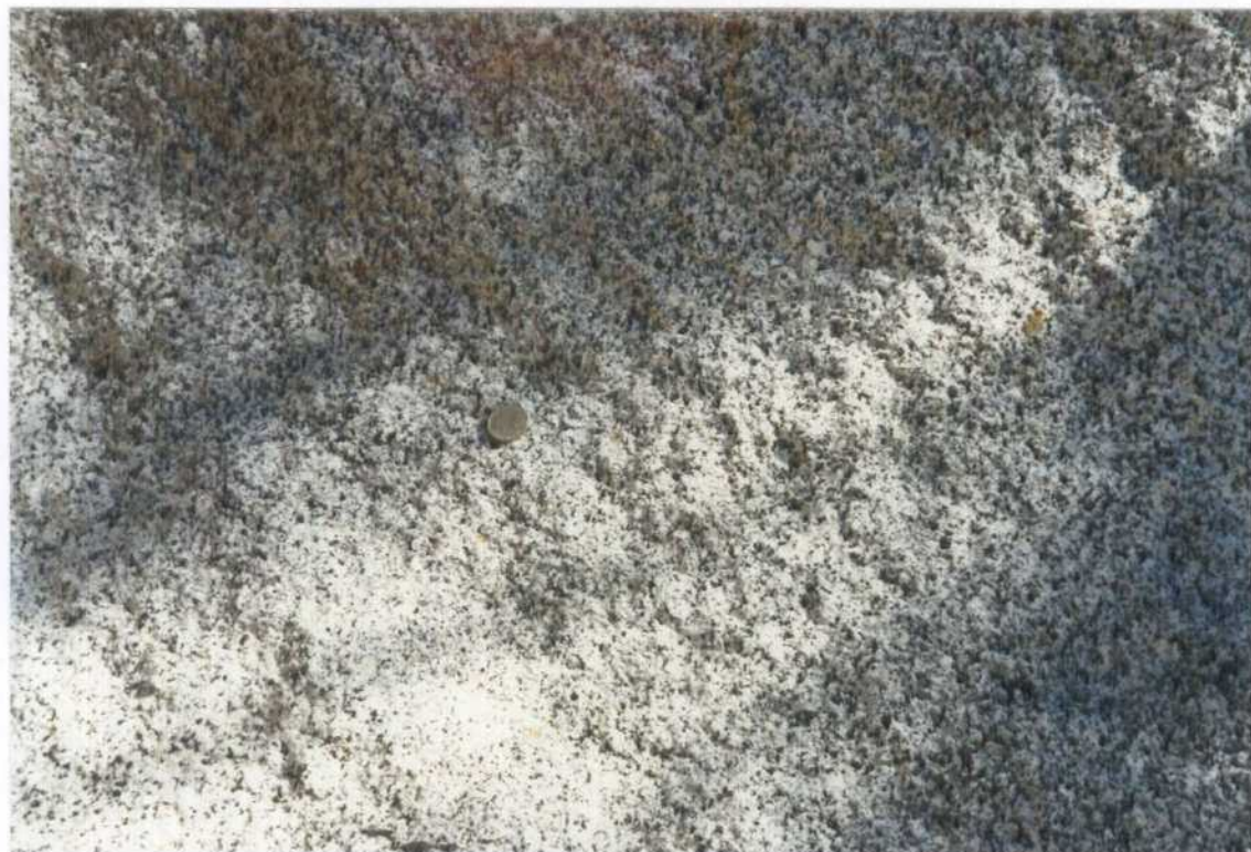
Foto 27 (54/D36).- Hoja 216. Detalle de la roca de la fotografía anterior. Se observan algunos puntos de oxidación.
